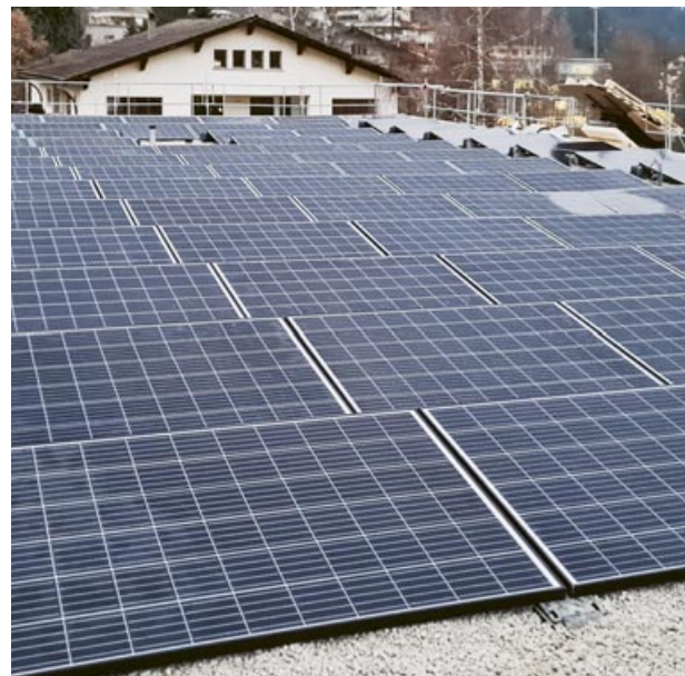
Photovoltaikanlage auf dem Dach der Schulhausanlage in Illanz.
