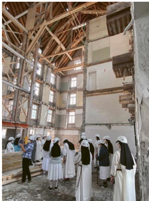
Die Ilanzer Dominikanerinnen besuchen die Baustelle der Residenz St. Joseph, wo sie früher ihre Pflegerin-schule führten.
