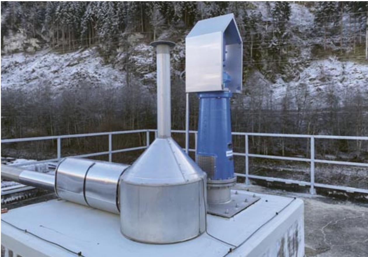
Auf dem neusten Stand der Technik: Die Kläranlage in Rueun.
