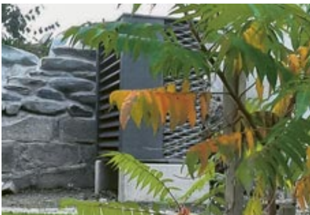
22 Diskret getarnt den Blicken entzogen: Wärmepumpe mit Aussengerät.
