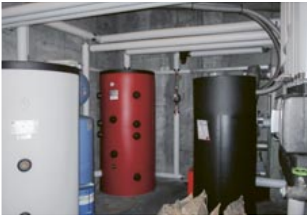
Die veraltete Heizungsanlage von Castrisch ...
